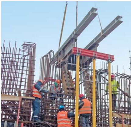
Bild 19. Einbau der Verankerung in den Pfeiler der Klappbrücke Sobieszewo Fig. 19. Placing the anchorage construction at the pier of the bascule bridge Sobieszewo
