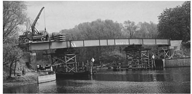
Bild 1 Verlegen der Betonfertigteile auf der Wirtschaftswegbrücke über die Hohensaaten-Friedrichstaler Wasserstraße [10] Precast concrete elements on the bridge over the Hohensaaten-Friedrichstaler waterway
