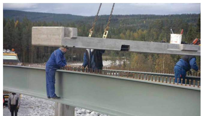
Bild 4 Geschlossene Verbundfuge in den eingehobenen Segmenten [17] Closed composite joint in the precast segments
