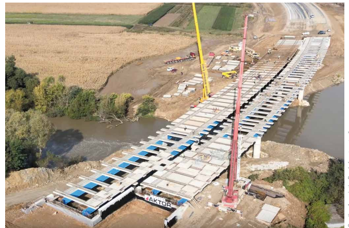
Bild 12 A 10 Sebeş-Turda Muresviadukt km 40 + 200: Verlegen der Fahrbahnmodule auf den Trägerrost A10 Sebeş-Turda Mures viaduct km 40 + 200: Mounting the roadway modules on the girder grid
